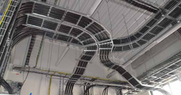
▲ Obr. 7 Příklad zvlášť vysokého zatížení svazky kabelů působícího na jedné vlně
