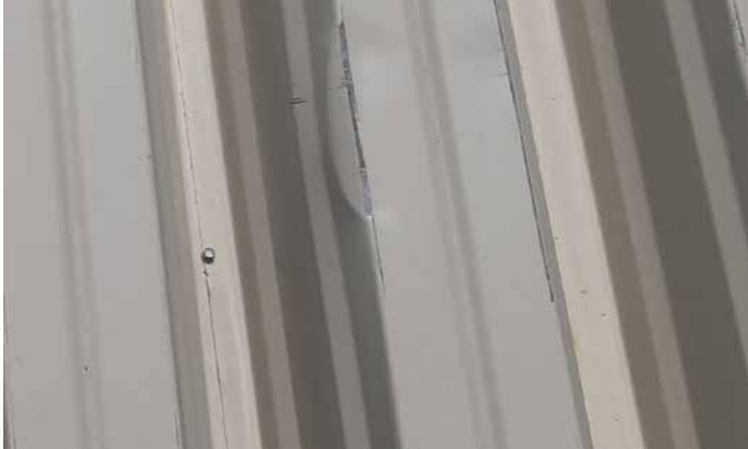
▲ Obr. 13 Zdeformovaná vlna – poškození při montáži
