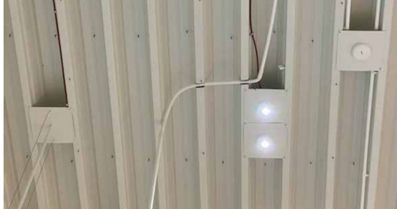
▲ Obr. 14 Poškozená spodní vlna – průchod kabelů
