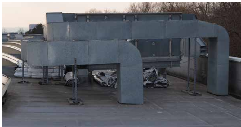
▲ Obr. 14 Skladovaný materiál na střeše a lokální zatížení jednotlivých vln
