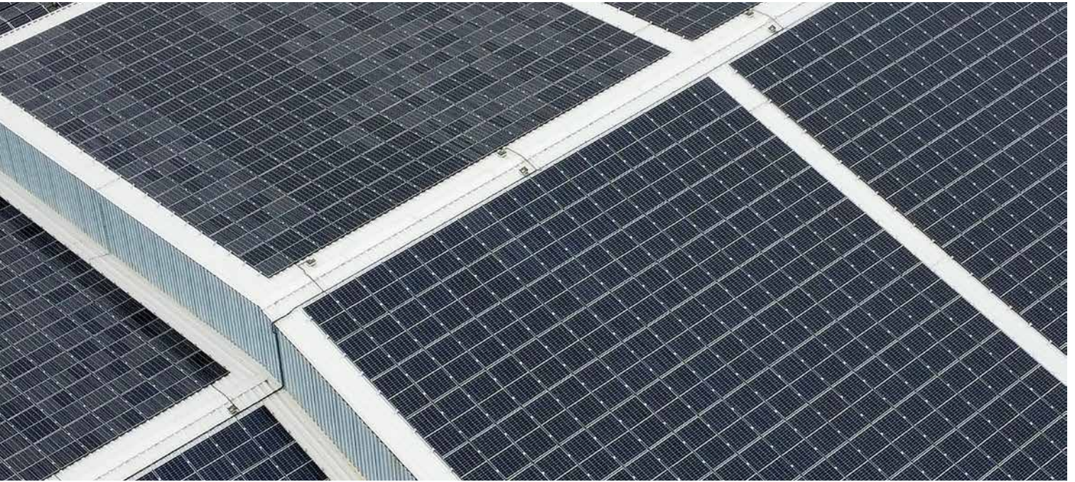
▲ Obr. 1 Fotovoltaické panely na střeše haly
