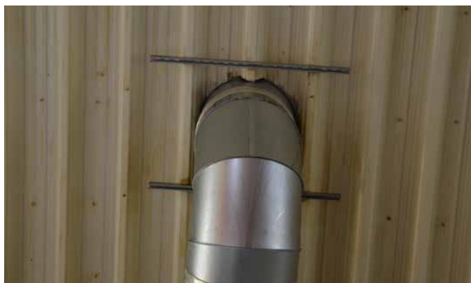
▲ Obr. 10 Prostup trapézovým plechem zajištěný výměnou do ostatních vln – sousední vlny jsou výrazně více namáhány, roznášecí prvek má diskutabilní nosnost i tuhost
