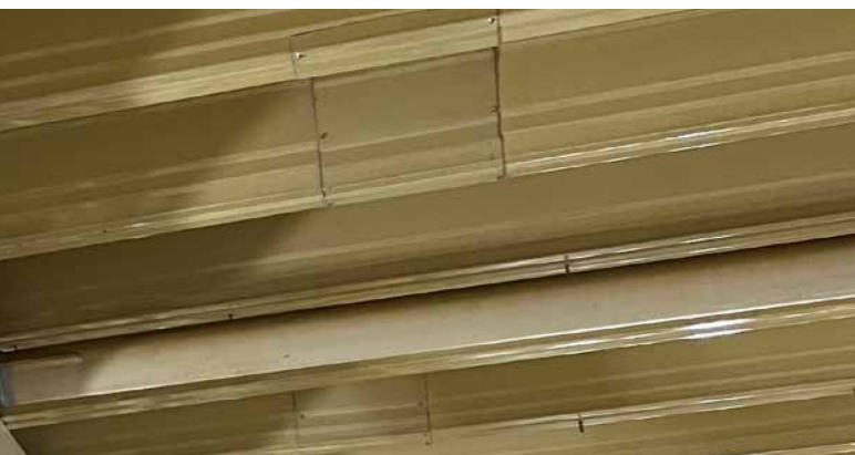
▲ Obr. 11 Prostupy trapézovým plechem zajištěné „záplatou“ o neznámé statické účinnosti
