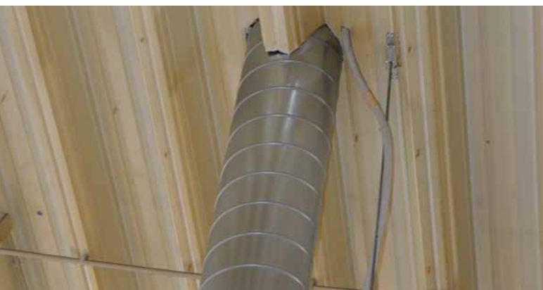
▲ Obr. 9 Nezajištěný prostup trapézovým plechem – přerušená spodní vlna a stojiny trapézového plechu
