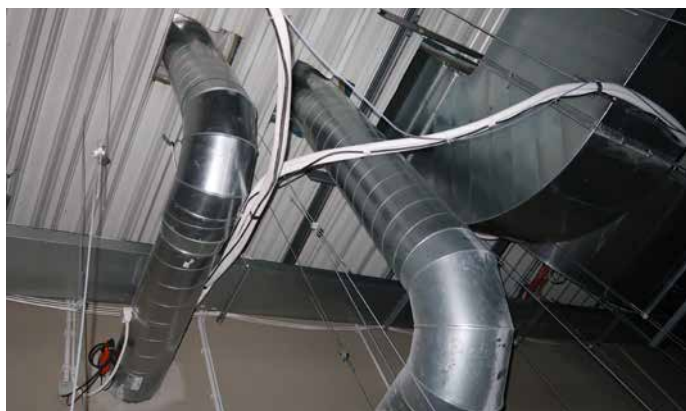
▲ Obr. 12 Nezajištěný prostup trapézovým plechem – přerušená vlna trapézového plechu
