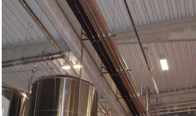
▲ Obr. 8 Příklad zvlášť vysokého zatížení množstvím potrubí působícího na jedné vlně v kombinaci s ukotvením na ŽB průvlak
